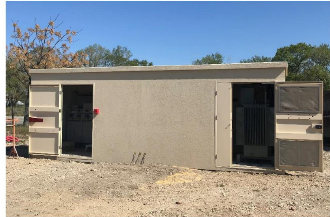
Figure 7 : Photographie d'un poste de livraison/transformation
